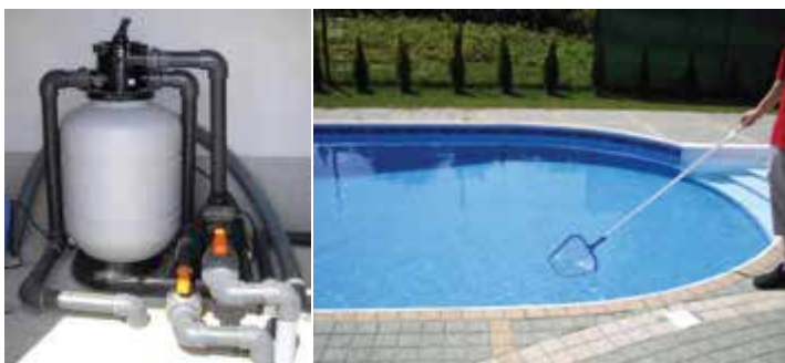
Obr. 2.14 Filtračné zariadenie záhradného bazéna
